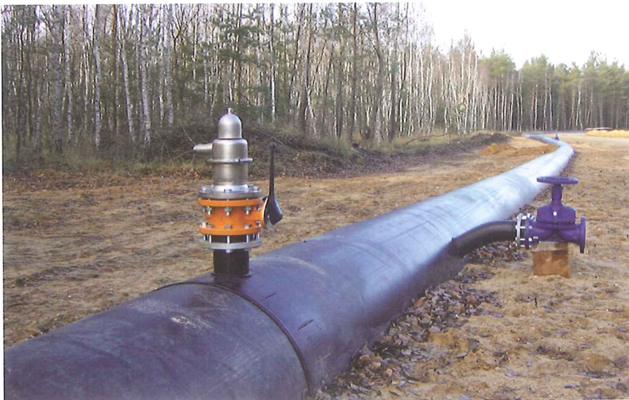
Tagebauentwässerung: Hier kommt das Ventil mit seiner Doppelfunktion zum Einsatz.
